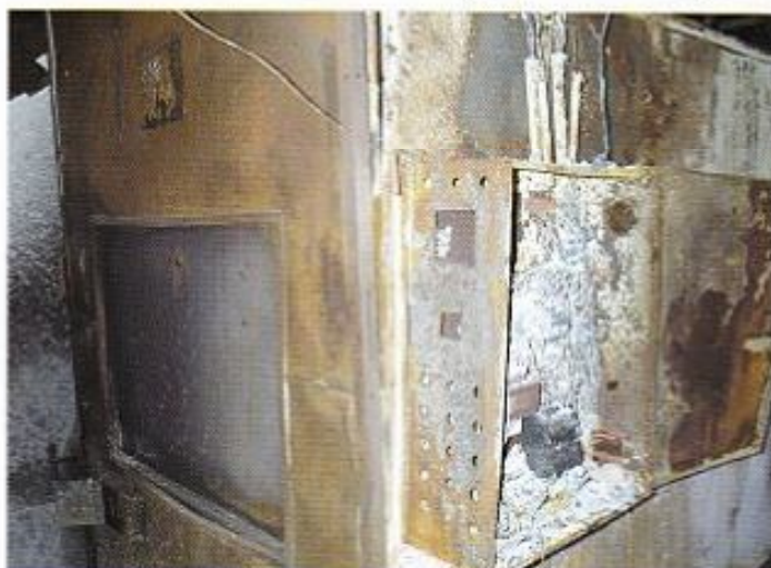
Zniszczony przez pożar piec w izraelskiej spoielarni
