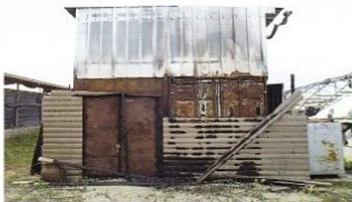
Doszczętnie spalone krematorium w Izraelu.
